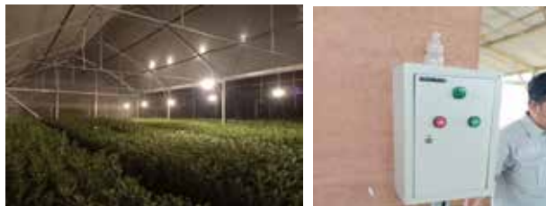
Gambar 14. Sarana Instalasi Pencahayaan
