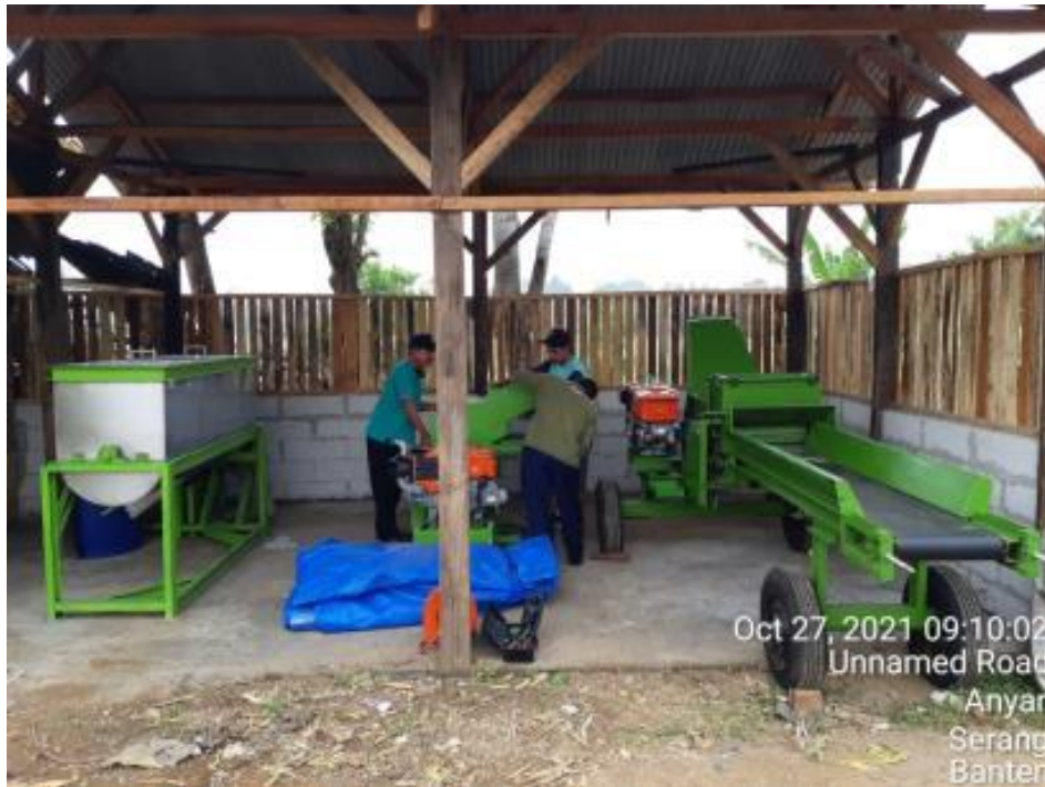
Gambar 25. Mesin pengolahan pakan ternak yang sudah terpasang di dalam pabrik mini pakan
