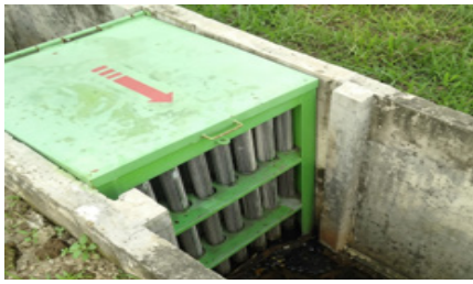
Gambar 2. FIO yang Sudah Terpasang di Saluran Irigasi (Mamat & Sukarman, 2020)
